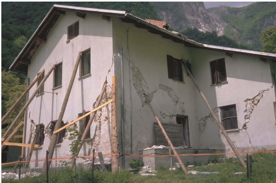
Globoke razpoke v vseh nosilnih stenah in delna porušitev vogalov konstrukcije so značilne poškodbe objektov iz neobdelanega kamna. V pritličju sirarne na planini Polog nad Tolminko v neposredni bližini Osojnice so se zaradi posedanja etaže porušile vse predelne stene. (Makroseizmični arhiv, ARSO)
