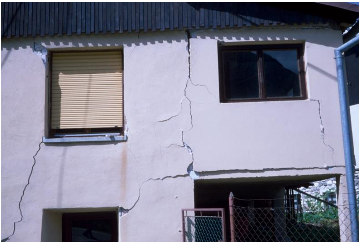
Močno poškodovana hiša v Čezsoči kaže neprimerno dozidavo prizidka (Makroseizmični arhiv ARSO)
