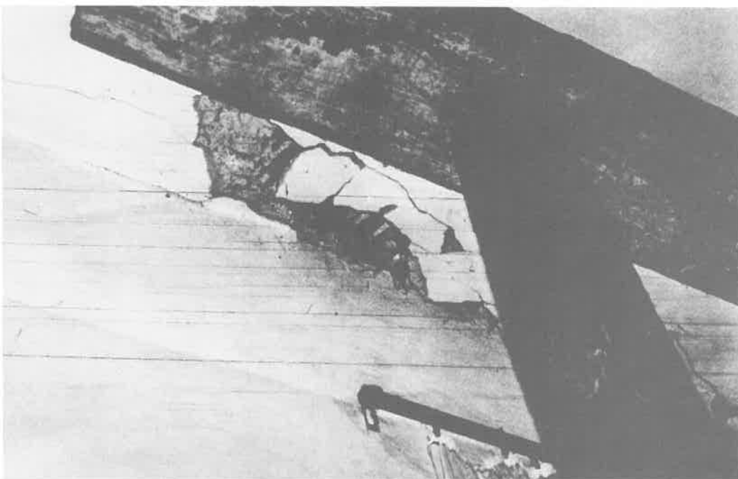
Slika 12: Popuščanje stropne konstrukcije zaradi napake na opori. Stropniki ne nalegajo na nosilni zid. Pri potresu so delno izgubili podporo (Muta, Cesta 4. julija 4).
