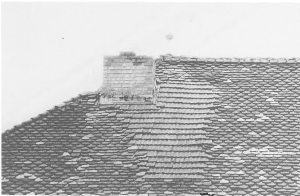
Slika 11: Odlomljeni dimnik na starem samostanu v Radljah ob Dravi (strešna opeka je že obnovljena).
