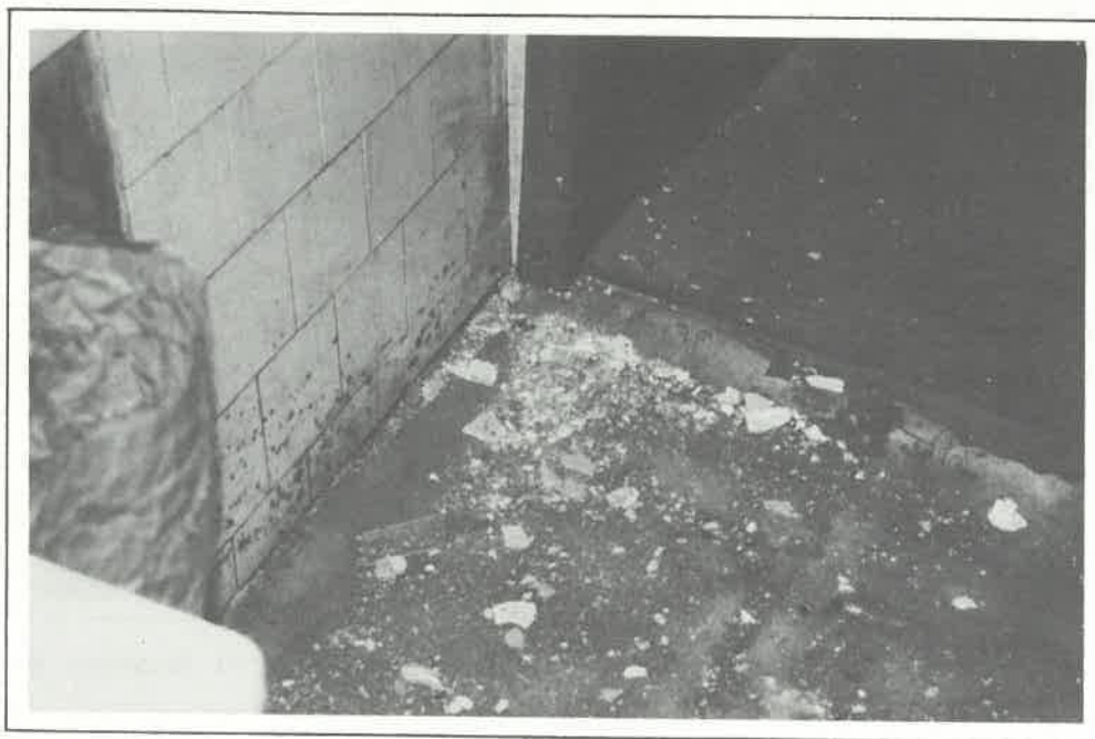
Slika 22: Pogled na odpadle večje kose ometa, ki so ležali vsepovsod po tleh objekta.
