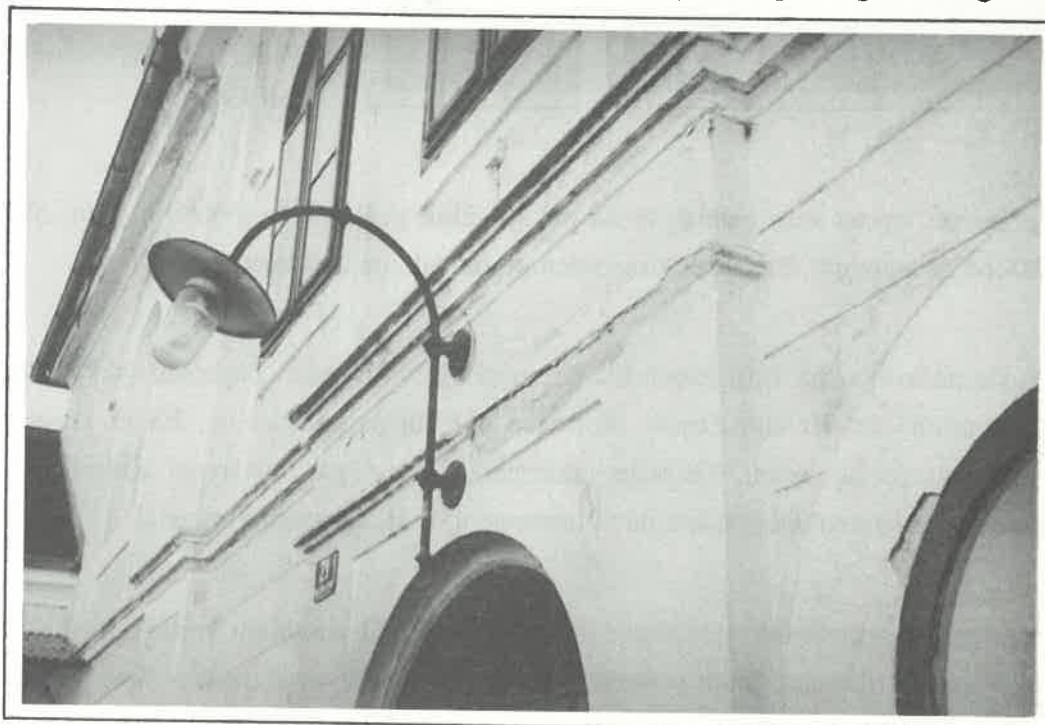
Slika 11: Med potresom je prišlo do odpada dela štukature nad vhodnimi vrati.
