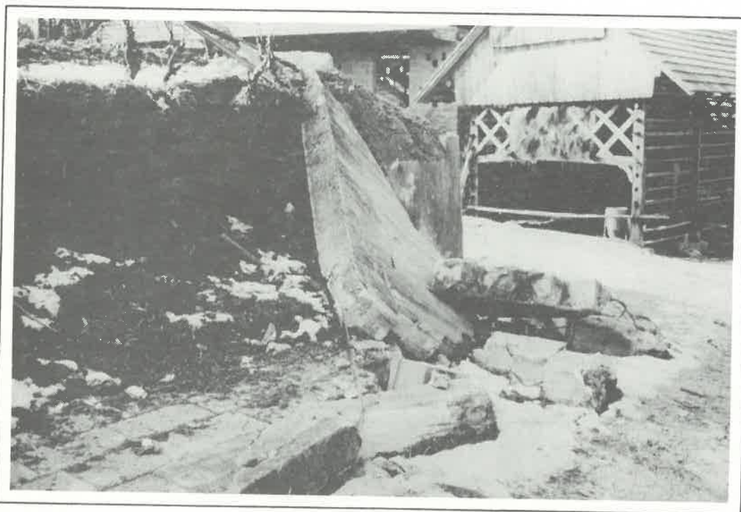
Slika 5: Pogled na detajl podrtga opornega zidu, kjer je vidna armatura slabe armiranobetonske vezi.
