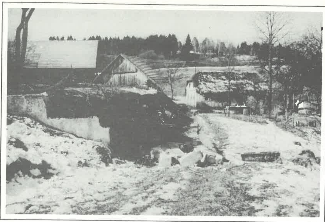
Slika 4 : Pogled na podrt oporni zid sezidan iz betonskih votlakov z armiranobetonsko povezavo na vrhu zidu. Dolžina zidu je 15 m, višina pa od 1.5 m do 2.8 m.
