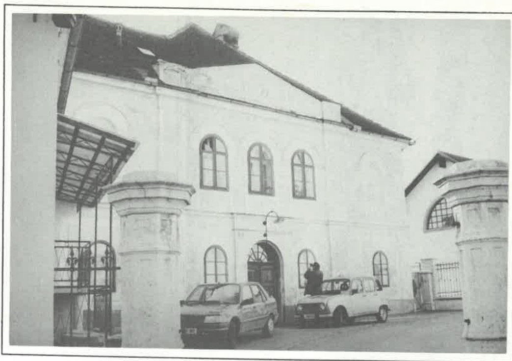
Slika 10: Župnišče v Vrhniki. Okoli 200 let star objekt se je različno stresel in zato so nastale manjše poškodbe.
