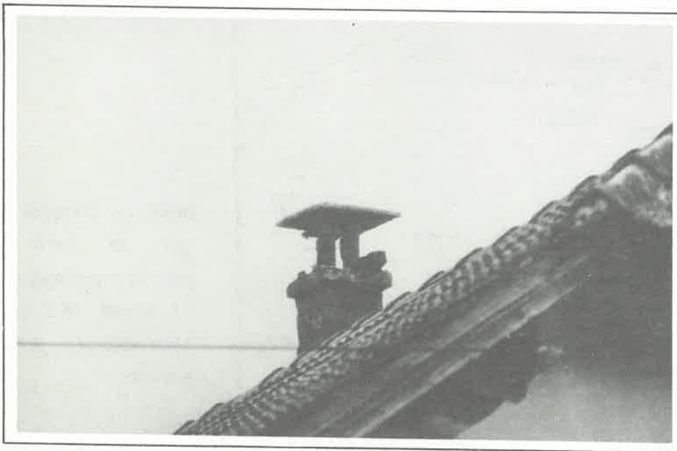
Slika 19: Pogled na delno odlomljen dimnik. Med potresom se je dimnik zasukal za 40°.
