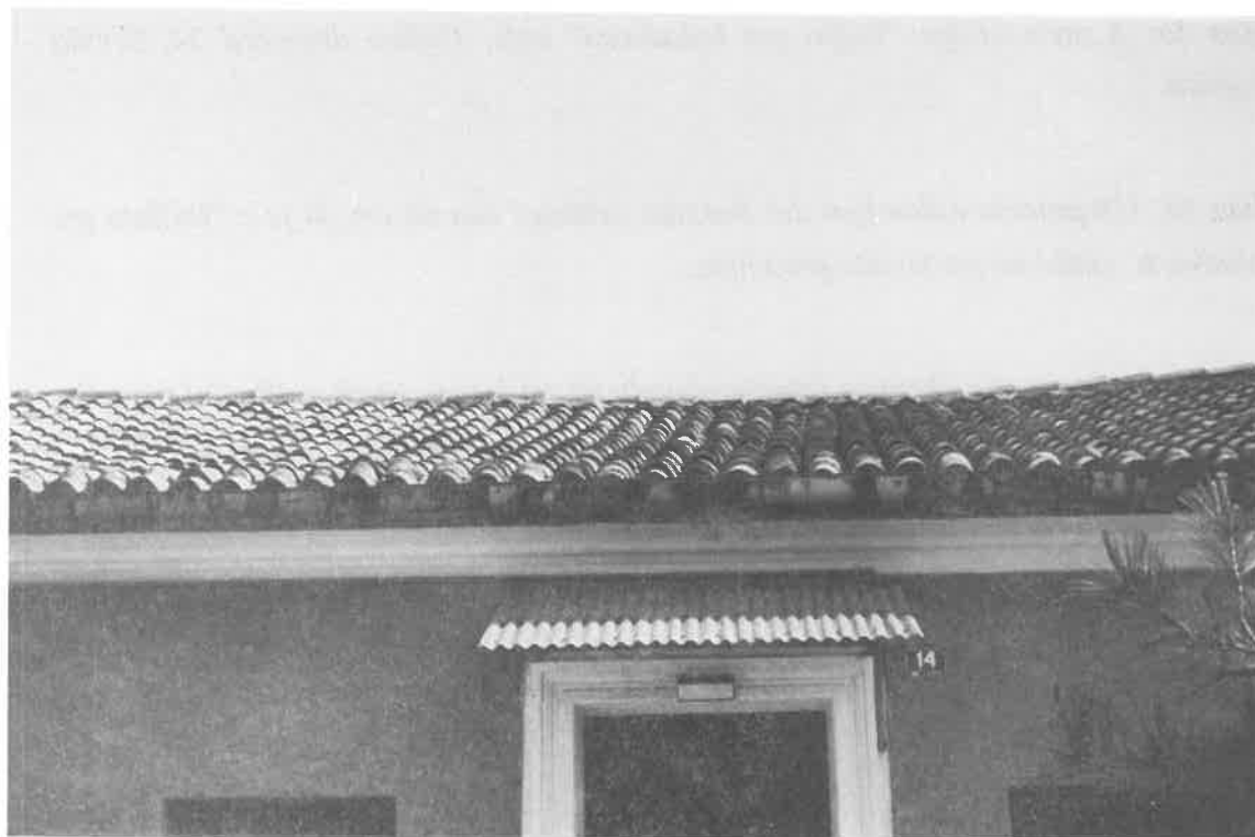
Slika 32: Posedanje strehe na stanovanjskem objektu v Ilirski Bistrici, Ulica Nikole Tesle 14. Verjetno so bili posedki prisotni že pred potresom zaradi slabih talnih pogojev.
