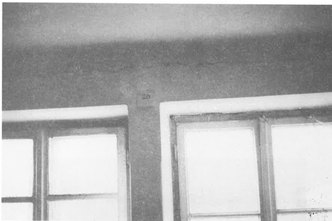
Slika 27: Razpoke na stiku nosilnih zidov in stropne konstrukcije v stanovanjski hiši v Ilirski Bistrici, Gregorčičeva ulica 30.
