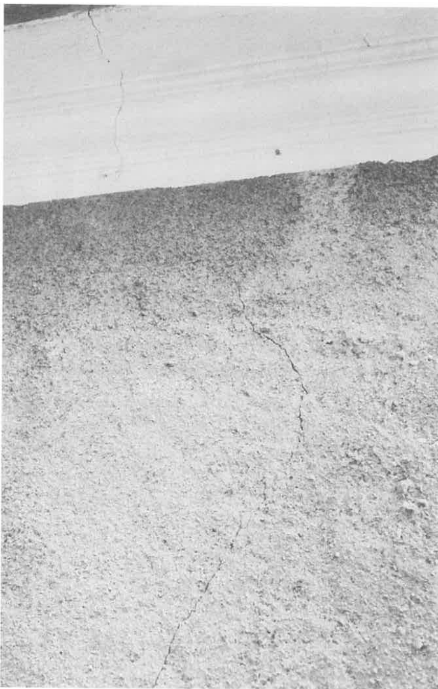
Slika 30: Globoke razpoke v zunanji nosilni steni na stanovanjski hiši v Ilirski Bistrici, Ulica Nikole Tesle 14.
