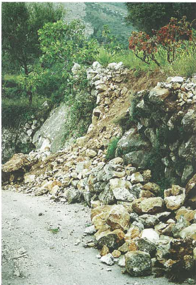
Slika 3. Marsikje so se porušili oporni zidovi. Slika kaže primer na cesti pri vasi Mravinca. Zidove sestavlja nepovezan in neobdelan kamen.
