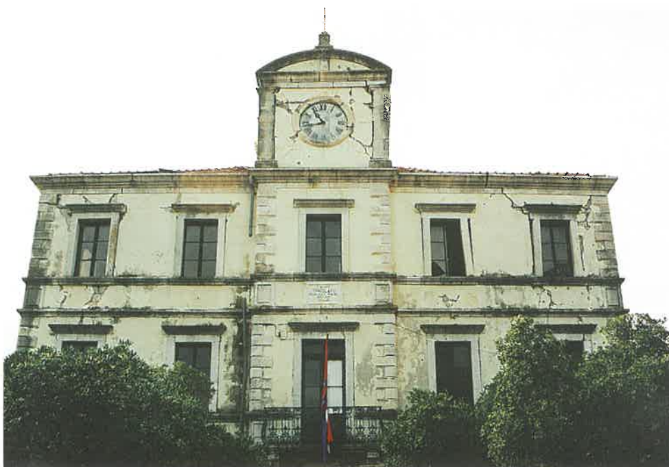
Slika 6. Pogled na zgradbo občine v Stonu. Objekt je utrpel hude poškodbe, ob oknih so vidne diagonalne razpoke. Fig. 6. A view of the municipal building in Ston. The building suffered severe damage, diagonal cracks in the windows are visible.
