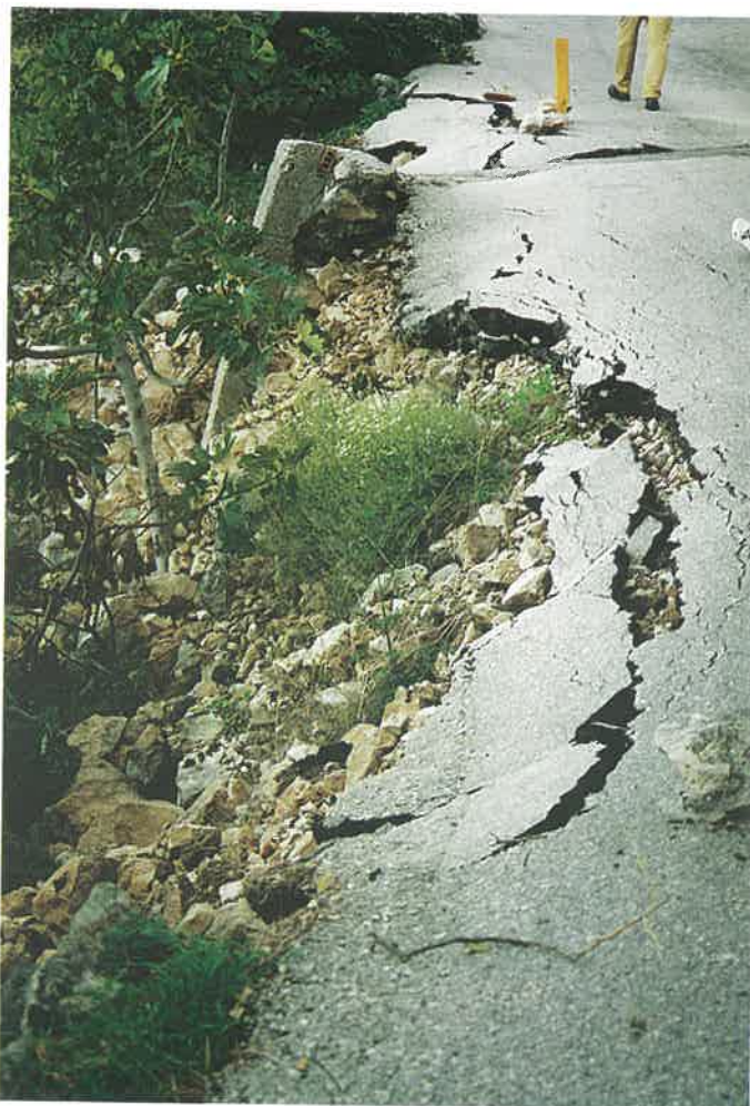
Slika 4. Odlom dela cestišča je posledica slabo komprimiranega nasutja.
