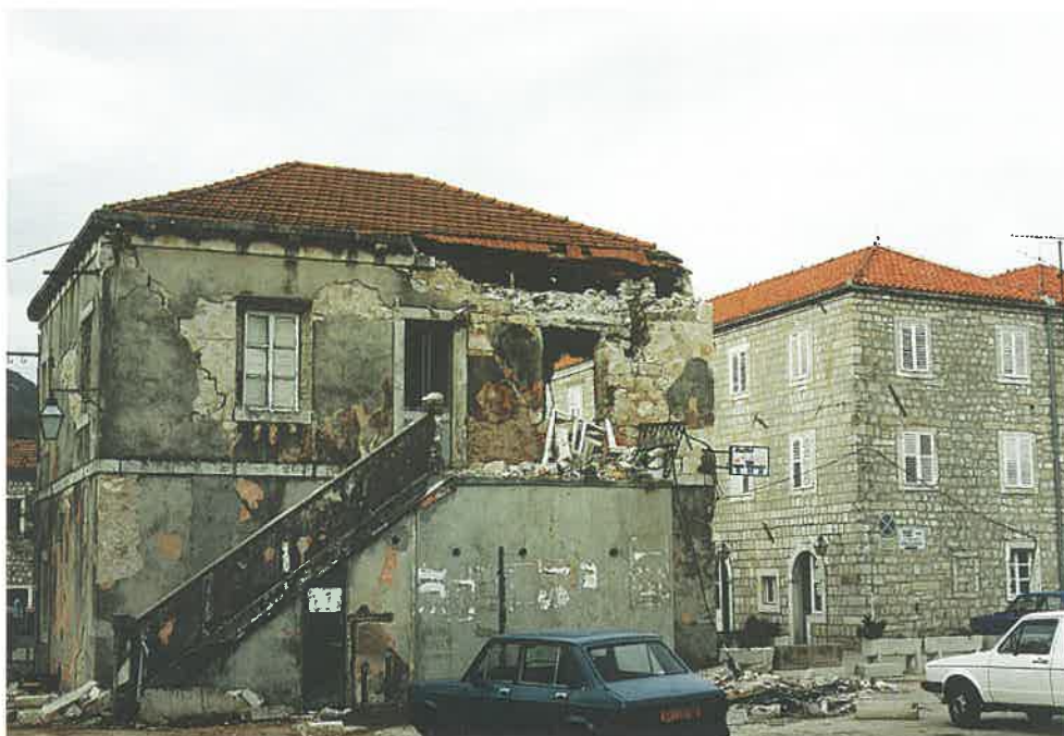
Slika 8. Edina preventiva pred potresi je potresno varna gradnja. Tudi v središču Stona stojita druga poleg druge stari hiši: desno so že pred leti ojačali in ni utrpela poškodb (tu je bil sedež poveljstva civilne zaščite), leva hiša pa je močno poškodovana.
