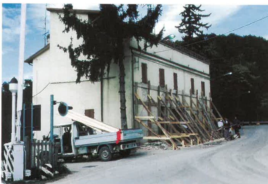
Slika 1. Nocera Scalo. Čeprav od zunaj ni videti večjih poškodb, so hišo ob glavni cesti podprli s tramovi. (Foto: J. Lapajne)
