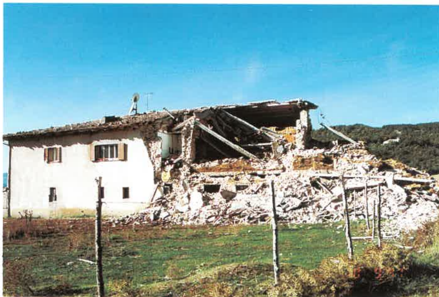
Slika 2. Osamljena kmetija blizu Colfiorita. Gospodarski del stavbe je utrpel veliko hujše poškodbe kot stanovanjski del. (Foto: I. Cecić)
