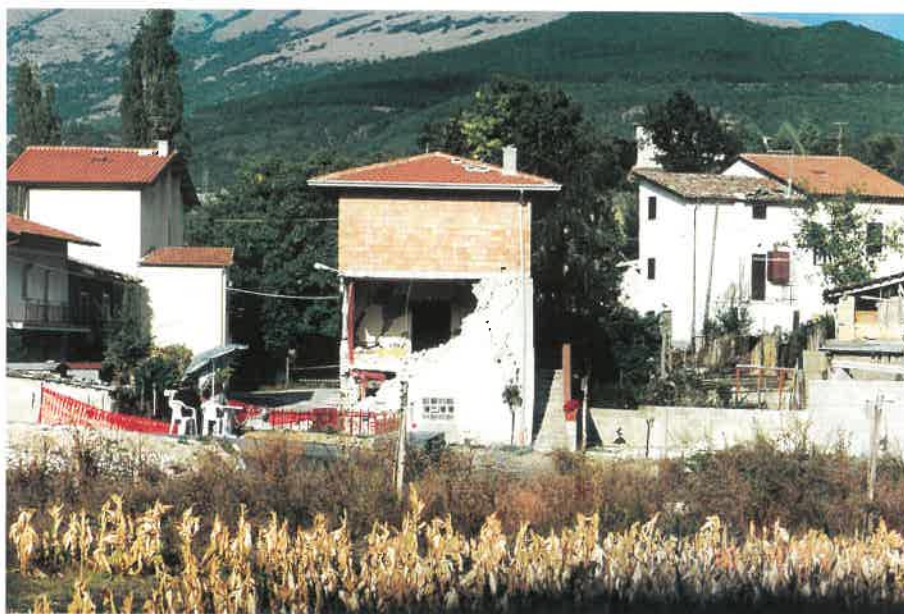
Slika 3. Le Moline. Delno porušena zunanja stena starejše hiše z dograjenim nadstropjem (foto: I. Cecić).
