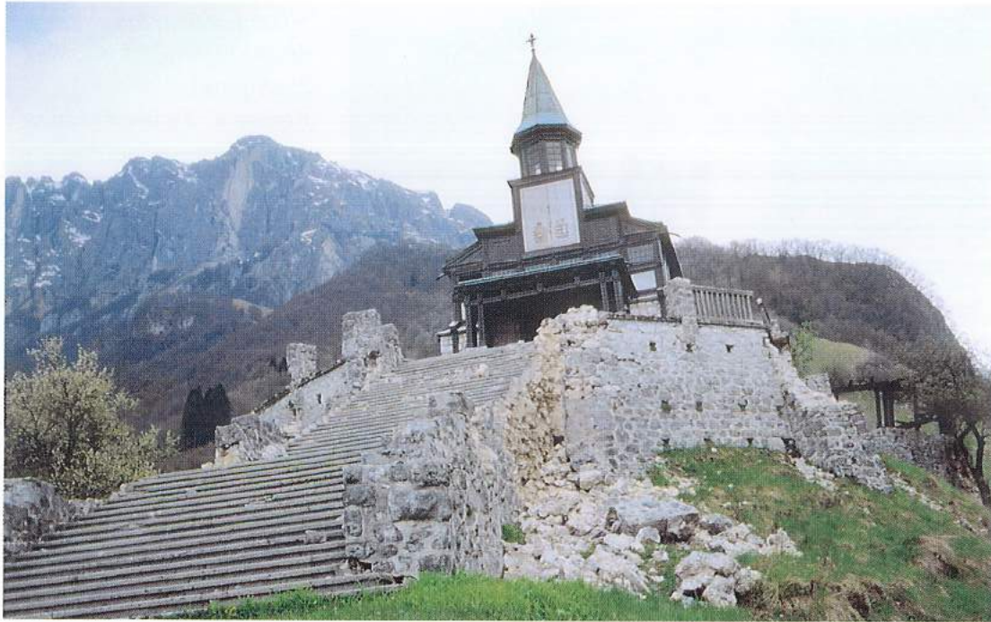
Slika 6. Podrti podporni zidovi na Javorca, lesena cerkev pa je vzdržala brez poškodb (poškodbe 2. do 3. stopnje)
