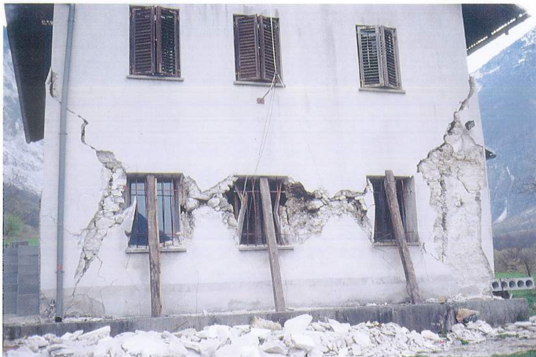
Slika 14. Uničena sirarna na planini Polog nad Tolminom (poškodba 5. stopnje) Figure 14. Destroyed cheese dairy on the Polog mountain above Tolmin (damage of grade 5).
