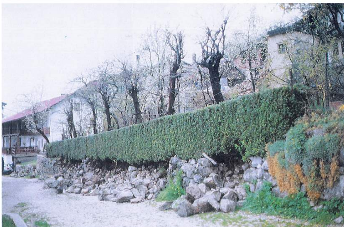
Slika 5. Podrt podporni zid v Magozdu (poškodba 2. stopnje)
