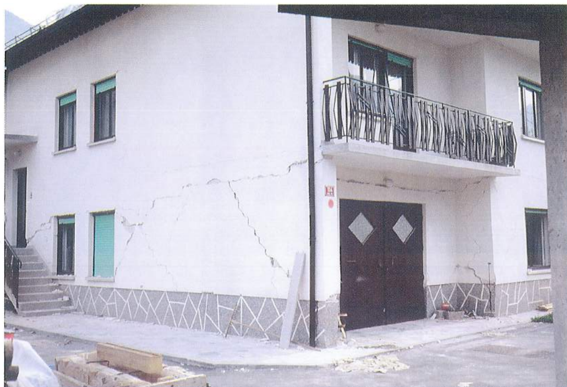
Slika 15. Močno poškodovana novejša stanovanjska hiša v Mali vasi v Bovcu (poškodba 5. stopnje) Figure 15. Heavily damaged, newer residential house at Mala vas in Bovec (damage of grade 5).
