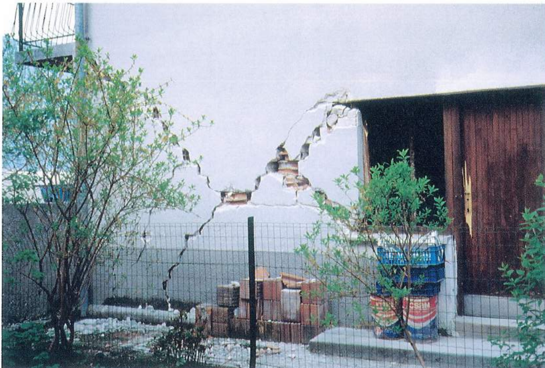
Slika 11. Močno poškodovan objekt (diagonalne razpoke) v Bovcu (poškodbe 4. stopnje). Figure 11. Heavily damaged house (shear cracks) in Bovec (damage of grade 4).
