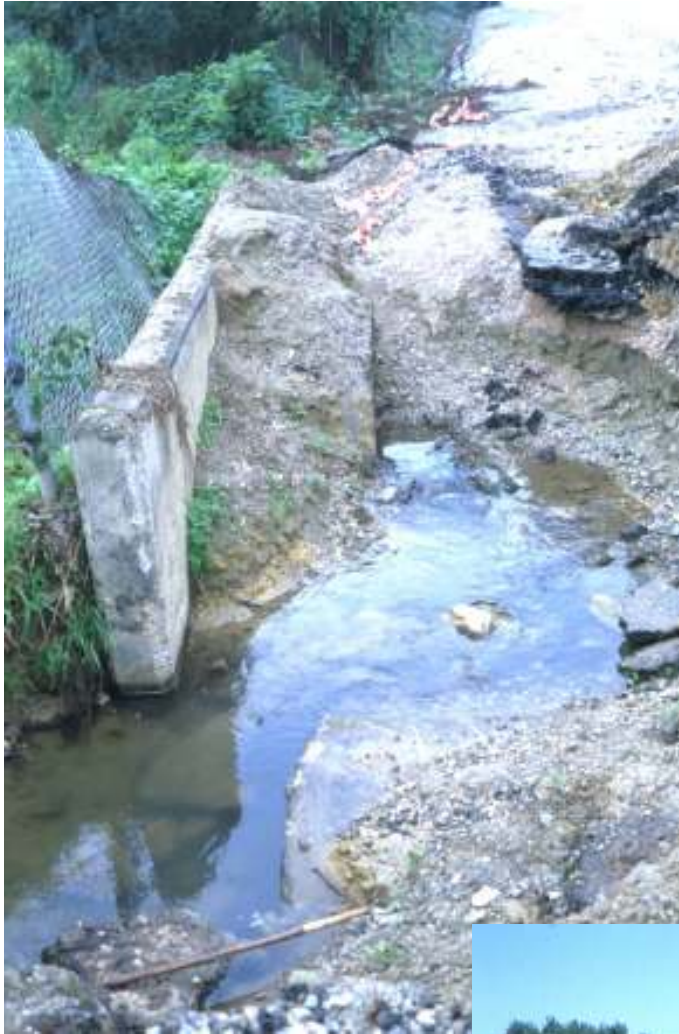
Slika 20. Zamik kanalizacijske cevi za 3,5 m (foto: R. Vidrih). Figure 20. Displacement of a drainage system pipe by 3.5 m (photo: R. Vidrih).
