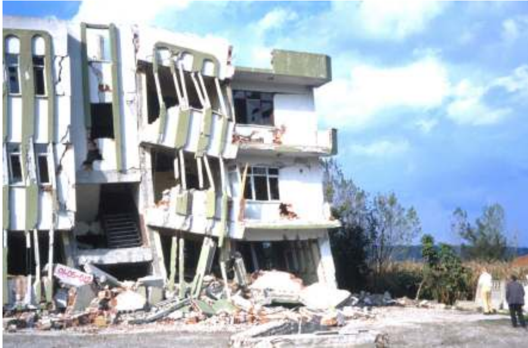
Slika 6. Porušitev pritličja, v katerem je bila trgovina. Objekt se je »zapeljal« v stran za višino pritličja (2,8 m). V zgradbi je bilo med potresom pet družin (okoli 30 ljudi) in nihče ni bil poškodovan (foto: R. Vidrih).
