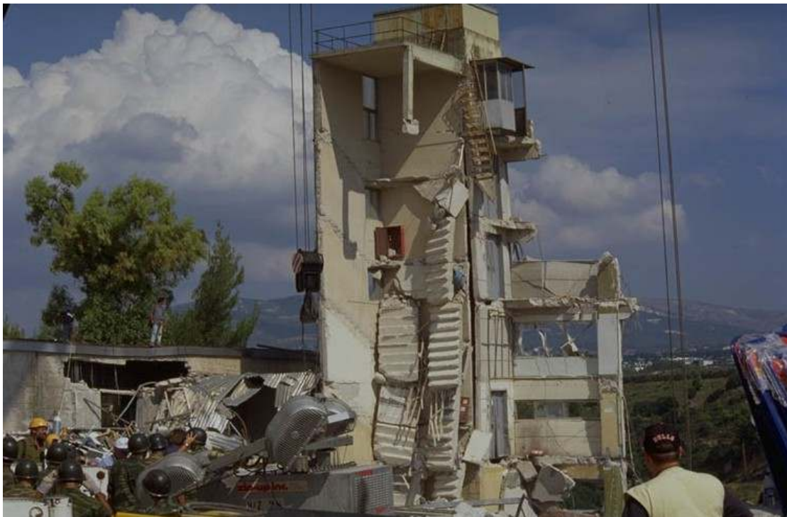
Slika 8. Močno poškodovana tovarna »Ricomex«, kjer je bilo na enem mestu največ žrtev potresa (več kot 30). Figure 8. The factory »Ricomex« collapsed and coased the highest life toll in a single place (more than 30).
