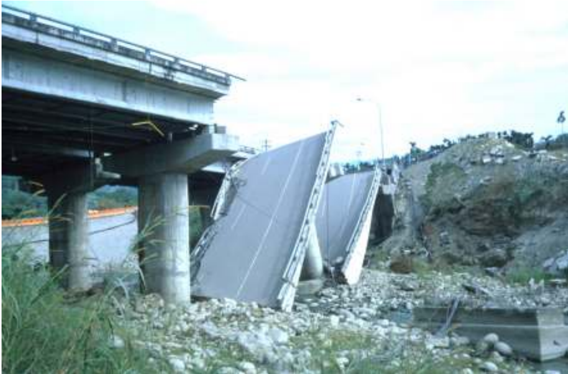
Slika 9. Vzrok porušitve mostu v Tung-Šinu je bilo slabo nalaganje prekladnih elementov v ležiščih (foto: R. Vidrih).
