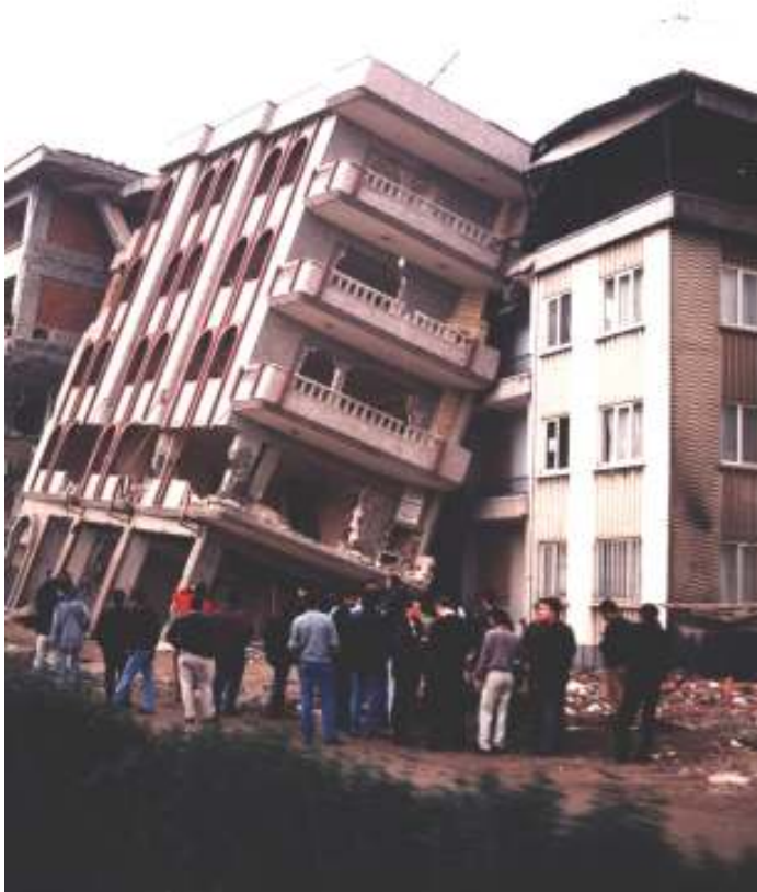
Slika 9. Zaradi izredno slabih geoloških razmer (tla slabe nosilnosti, zasičena z vodo), je ponekod prihajalo do nagnjenja ali posedanja objektov (primer na sliki je iz mesta Adapazar) (foto: M. Godec).
