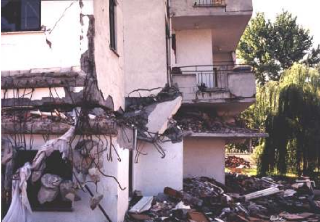
Slika 8. Detajl porušitve bloka v Seymenu (slika 7). Ko polnila v nadstropju popustijo se ta obnaša kot mehka etaža (foto: M. Godec).
