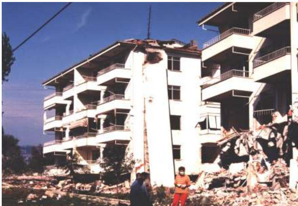
Slika 7. Popolnoma porušeno štiri leta staro naselje petnadstropnih blokov v mestu Seymen. Vzroki za porušitev nadstropij so bili nesegregiran beton, gladka armatura, redka stremena in slabi prehodi armature (foto: M. Godec).
