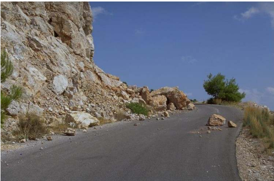
Slika 10. Na cesti med krajema Aspropyrgos in Fili so na cesto zgrmeli številni kamninski podori.
