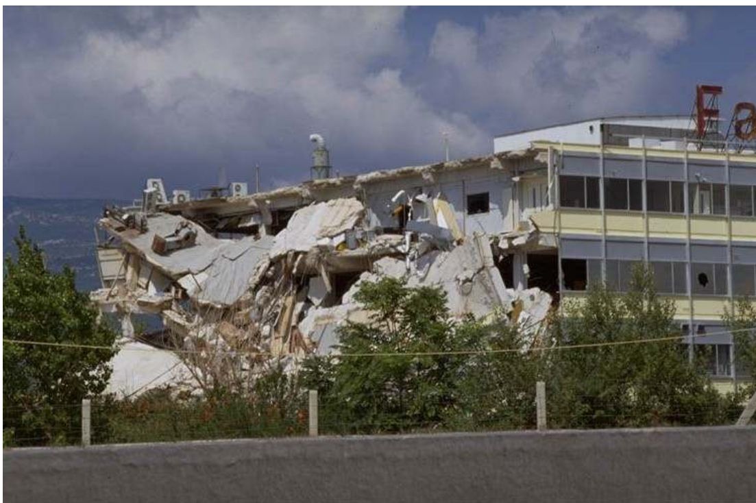
Slika 4. V večjem delu tovarne »Faran« je prišlo do težkih poškodb konstrukcijskih elementov.
