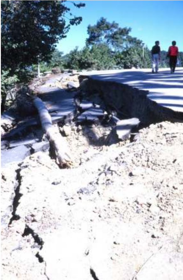
Slika 13. Zaradi plazenja, ki ga je povzročil potres, je prišlo do deformacije cestišča (foto: R. Vidrih).
