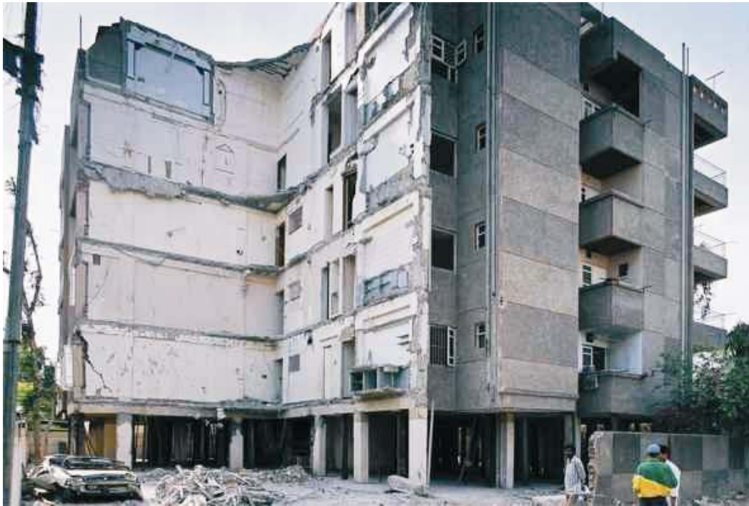
Slika 10. Značilna stanovanjska zgradba z odprtim pritličjem, kjer so bile garaže. Takšno pritličje se med potresom obnaša kot mehka etaža (pri močnem potresu stebri v mehki etaži ne zmorejo sprejeti potresnih sil).
