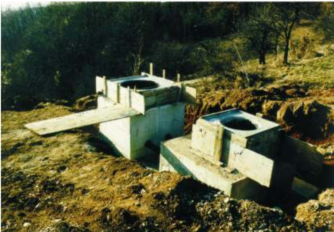
Slika 12. Stanje del na lokaciji Legarje 30. januarja 2002 (opravljena betonska dela, do 5. 2. 2002. opravljen zasip jame, položena telekomunikacijski in energetski kabel).
