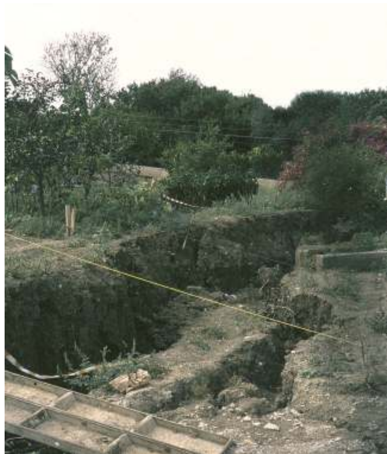
Slika 8. Sekundarni odlomni rob. Plazenje je zajelo tudi most, na srečo nobena zgradba ni bila poškodovana (foto: R. Vidrih).
