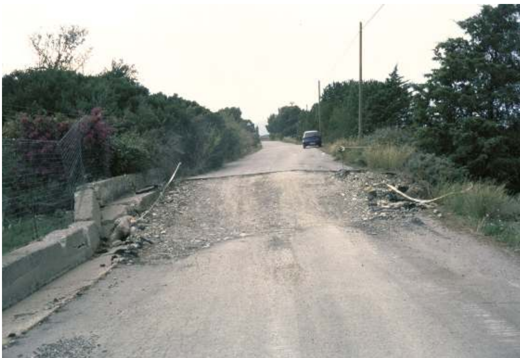
Slika 12. Plaz je premaknil betonski most za približno 20 cm, cestišče pa se je pogreznilo za približno pol metra (foto: R. Vidrih).
