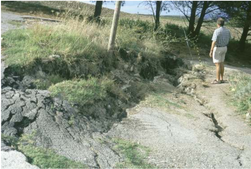
Slika 11. V nekaterih predelih se je cestišče pogreznilo za več metrov. V zgornjem delu plazu so vzdolžni premiki po pobočju največji, zaradi tega so poškodbe največje (foto: R. Vidrih).
