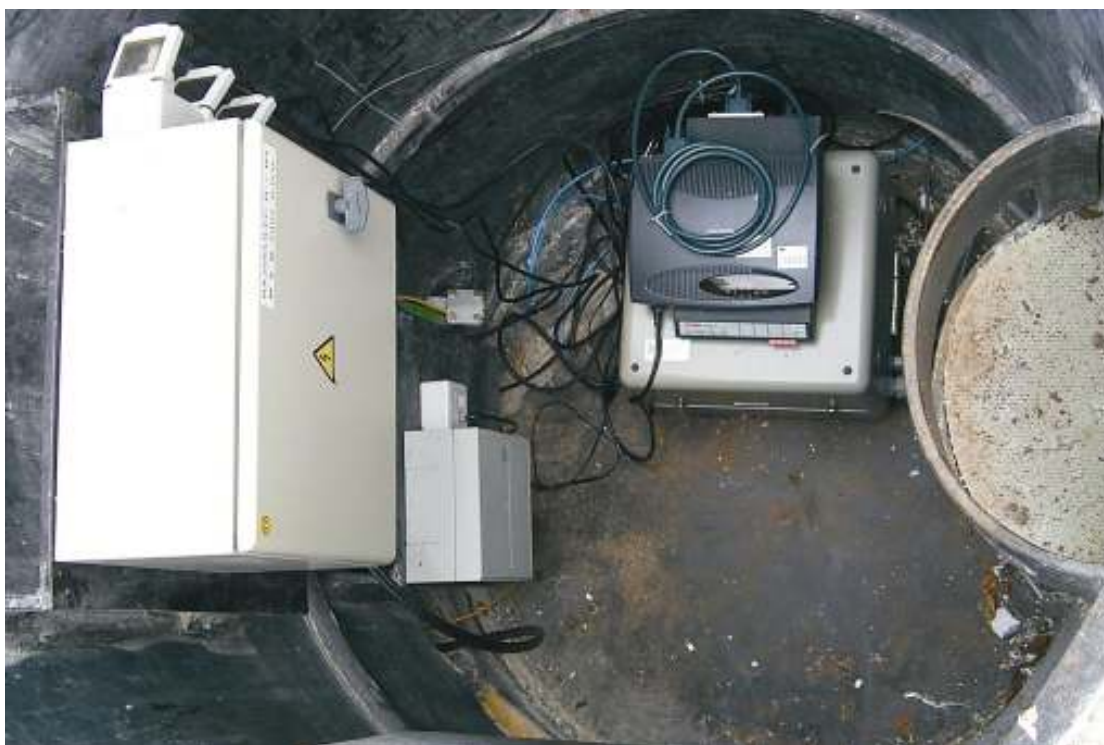
Slika 4. Napajalna enota in komunikacijska oprema sta nameščeni v pomožnem jašku Figure 4. Power supply and communication equipment are placed in auxiliary shaft
