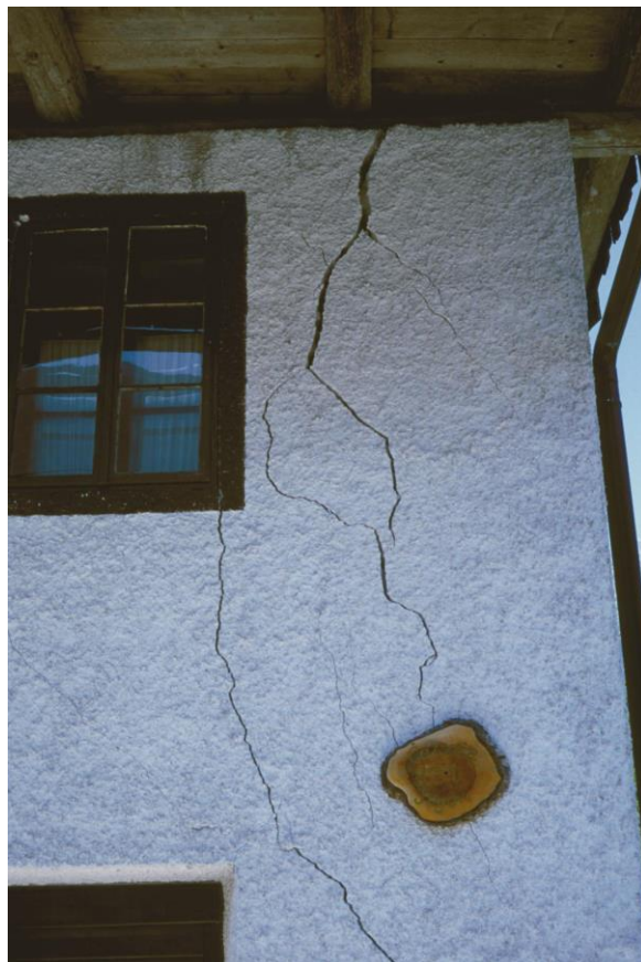
Slika 17. Razpoke na starejšem objektu v Čezsoči. Figure 17. Cracks on an older building in Čezsoča.
