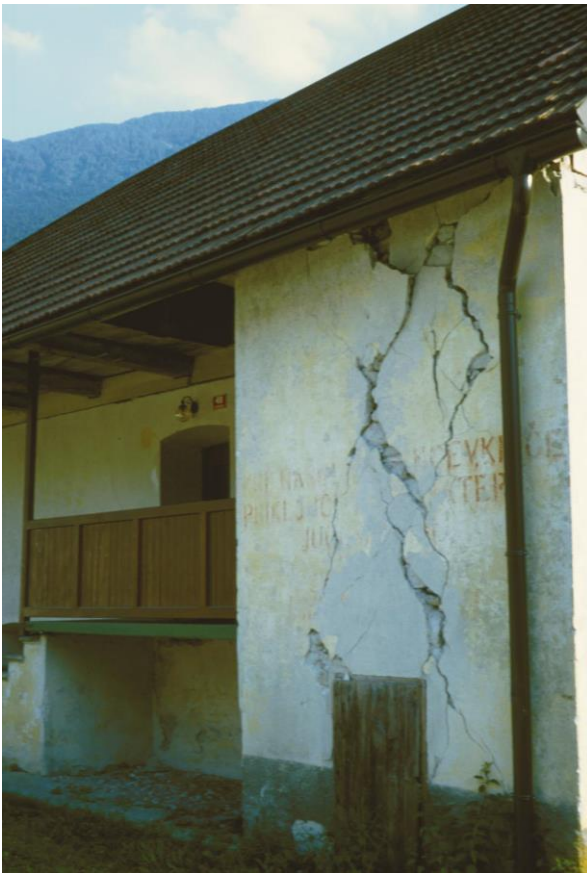
Slika 12. Globoke razpoke v starejših slabo grajenih objektih (Čezsoča).
