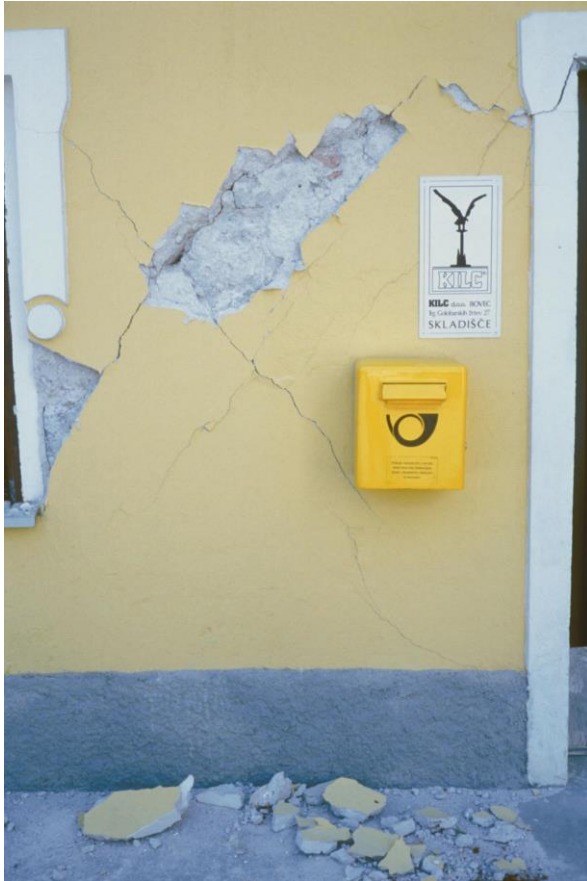
Slika 11. Diagonalne razpoke na pošti v Čezsoči.
