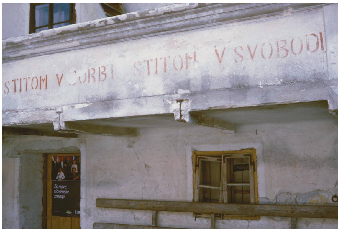
Slika 13. Močno poškodovana hiša v Čezsoči. Figure 13. Severely damaged house in Čezsoča.
