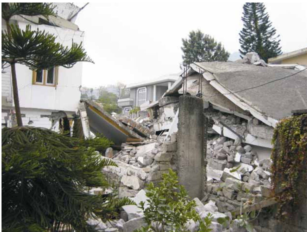
Slika 10. Muzaffarabad: v ospredju porušena hiša iz betonskih blokov, v ozadju nepoškodovana hiša iz opeke in levo močno poškodovana hiša iz kamnitih blokov.
