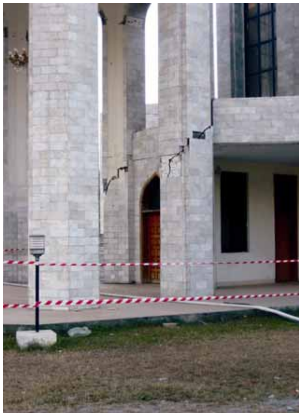
Slika 26. Muzaffarabad: palača vrhovnega sodišča. Strižne poškodbe neustrezno zasnovanih stebrov.
