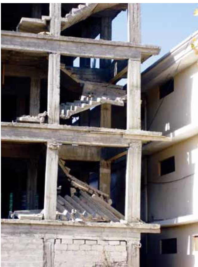
Slika 14. Detajl poškodb stopnišča v vogalu.
