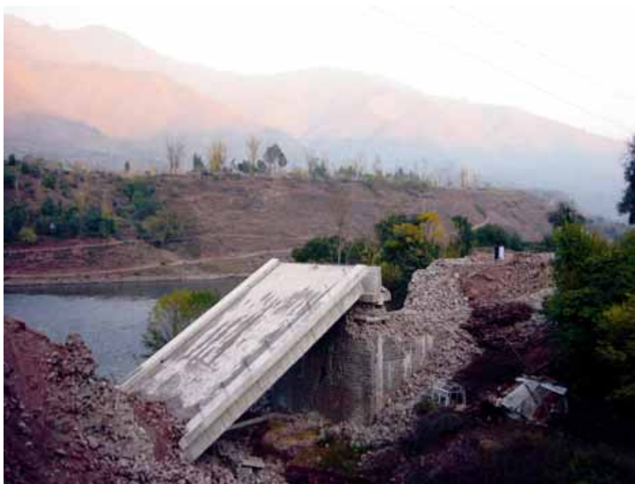
Slika 27. Muzaffarabad: padec nove prekladne konstrukcije cestnega mostu zaradi prevrnitve krajnjega opornika.
