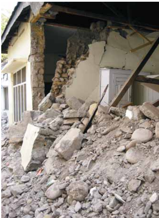
Slika 25. Muzaffarabad: delna porušitev zidane konstrukcije z nepovezanim zidovjem. Vidi se struktura kamnitega zidu.
