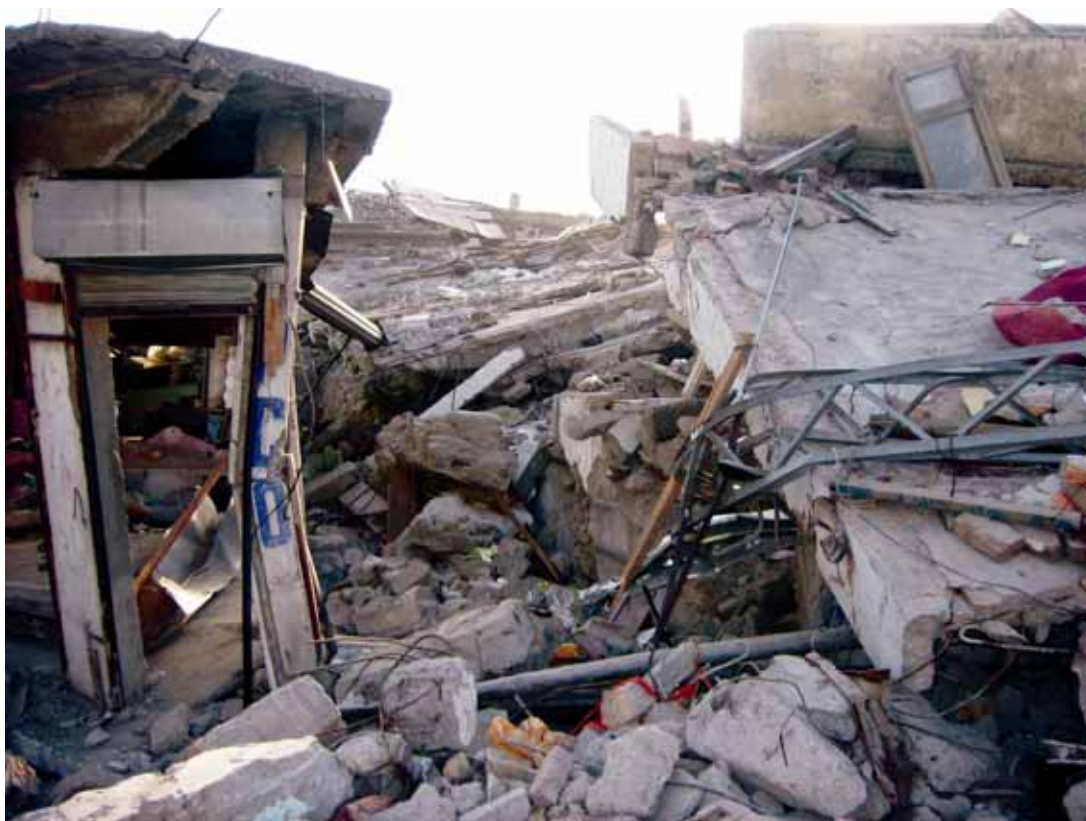
Sliki 17. Balakot: do nerazpoznavnosti porušena armiranobetonska konstrukcija. Figures 17. Balakot: it is not possible to identify the collapsed r.c. structure.
