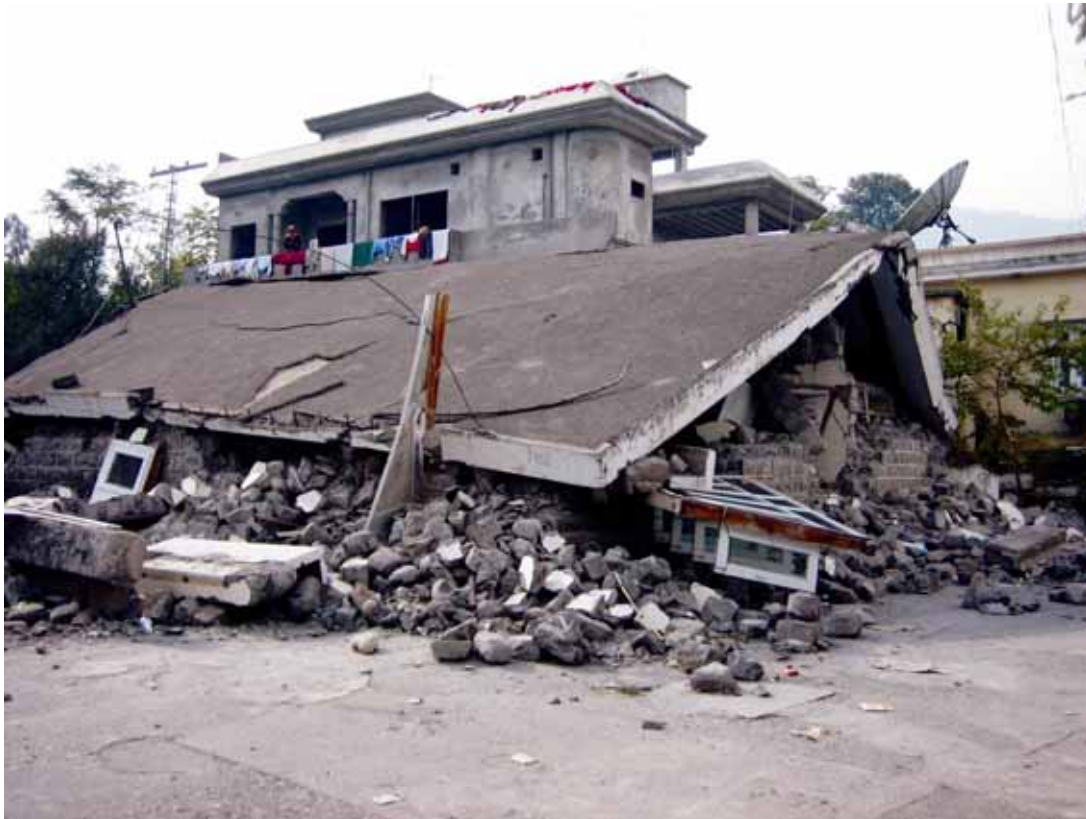
Slika 22. Muzaffarabad: porušena hiša, sezidana iz betonskih blokov. Figure 22. Muzaffarabad: collapsed house, built of concrete blocks.
