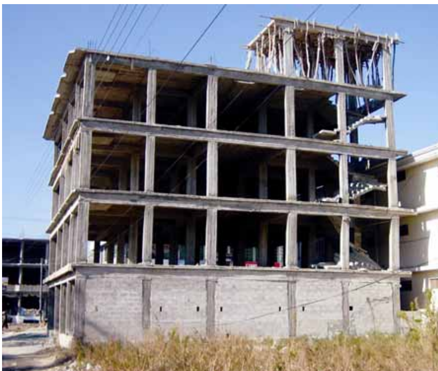
Slika 12. Abbotabad: nedokončana armiranobetonska okvirna konstrukcija z zidanimi polnili. Zidana polnila v pritličju so območje poškodb preselila v prvo nadstropje. V eni smeri šibki stebri in stopnišče v vogalu v enem od vogalov so povzročili nastanek plastičnih členkov v stebrih nad pritličjem, velike preostale deformacije zgornjega dela konstrukcije, zasuk konstrukcije zaradi torzijskih vplivov in hude poškodbe stopnišča.
