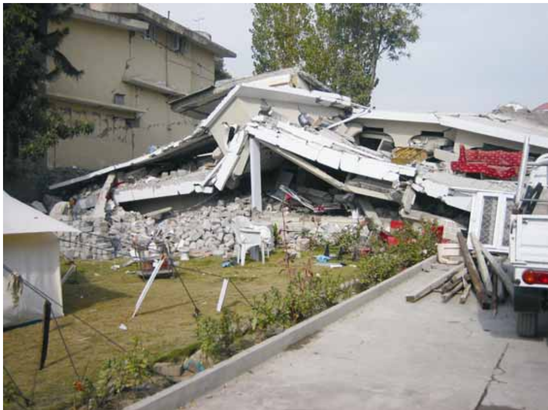
Slika 23. Muzaffarabad: porušena hiša, sezidana iz betonskih blokov. Figure 23. Muzaffarabad: collapsed house, built of concrete blocks.
