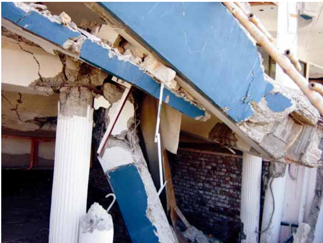
Slika 16. Abbotabad: detajli poškodb porušene armiranobetonske konstrukcije - plastični členki v stebrih in porušena medetažna konstrukcija.
