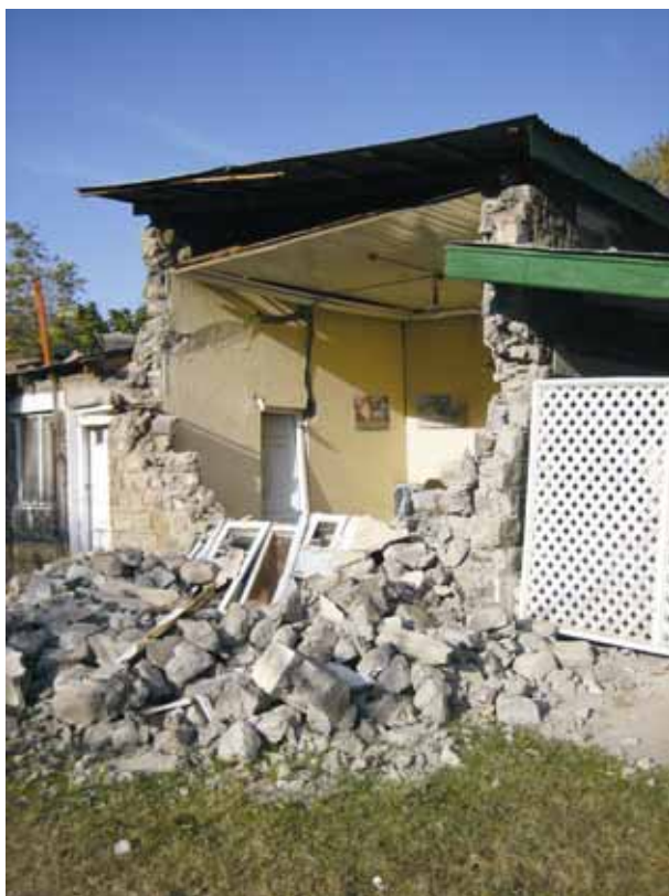
Slika 9. Balakot: zidovi niso povezani z vezmi. Porušitev kamnitega zidu zaradi nihanja pravokotno na ravnino.
