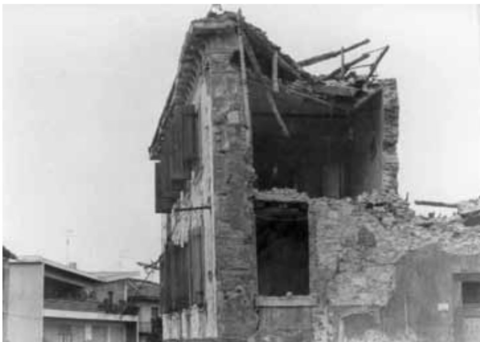
Slika 2. Tipične poškodbe pri VIII. stopnji EMS lestvice. Delne porušitve zgradb (zelo težke poškodbe na nekonstrukcijskih elementih) v Breginju (Arhiv ARSO, Urad za seizmologijo in geologijo). Figure 2. Typical damages grade VIII EMS. Partially demolished buildings in Breginj (Archive ARSO, Seismology and Geology Office).
