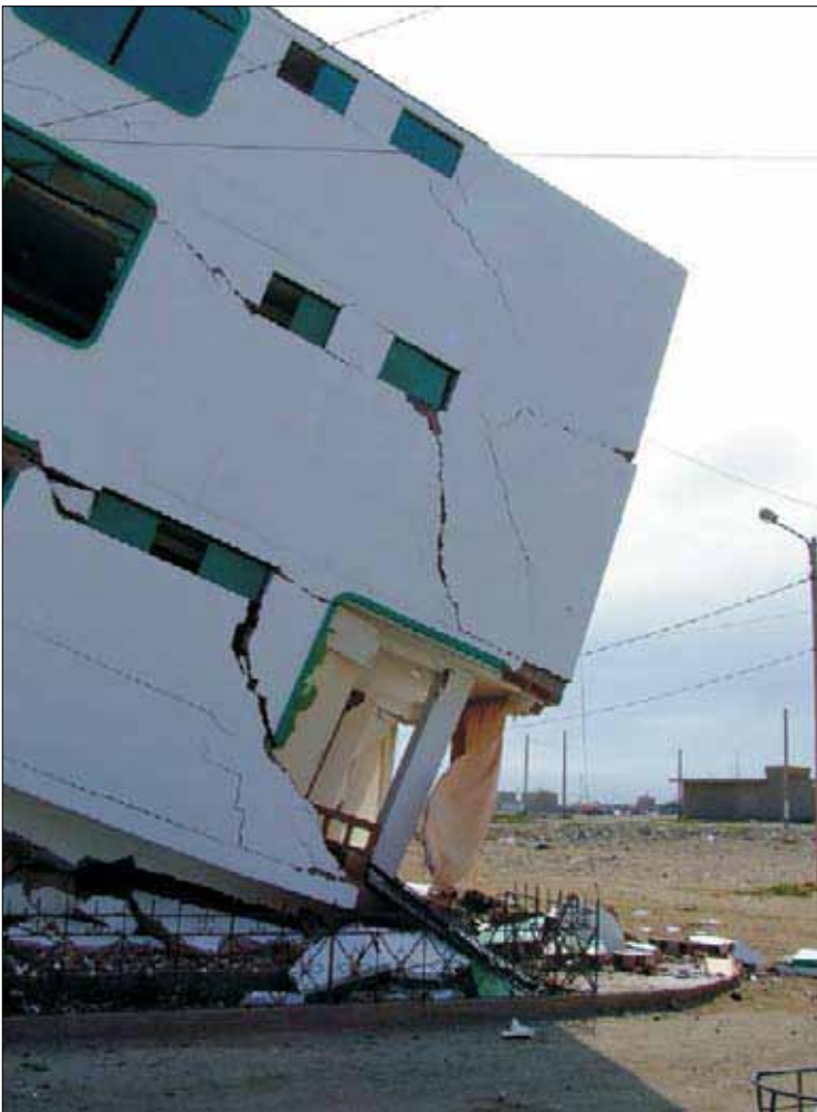
Sliki 11a,b. Porušitev armirano betonskega okvirja s polnili zaradi učinka mehkega pritličja.
