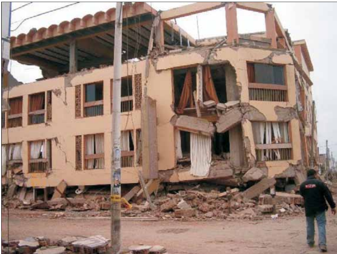
Sliki 9a,b. Armirano betonska konstrukcija hotela Embassy v kraju Pisco se je porušila zaradi krhkega loma stebrov v pritličju.
