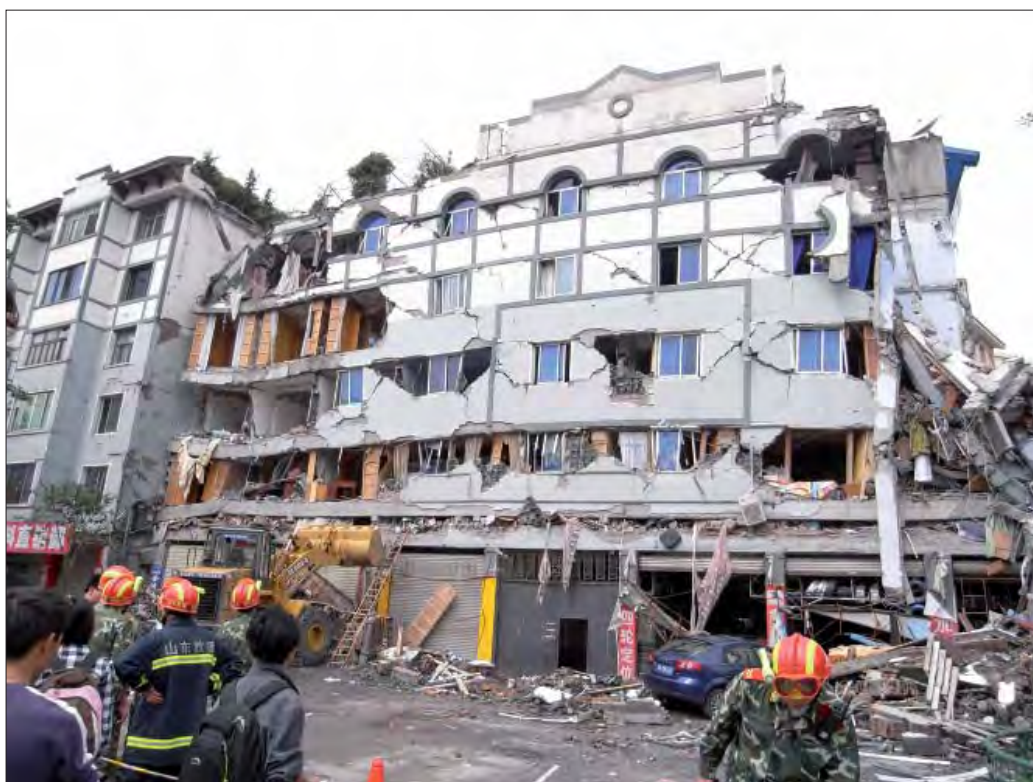
Slika 6. Porušitev običajnega tipa zgradb v mestih. Gre za 3- do 7- etažne zidane zgradbe z montažnimi betonskimi stropi brez potresnih vezi. Pogosto je pritličje armirano betonski okvir z velikimi odprtinami (trgovine, lokali, garaže). Na prikazanem objektu v mestu Dujiangyan je prišlo do porušitve prvega nadstropja.
