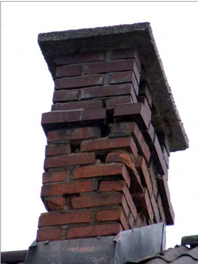
Slika 5e. Zagorje ob Savi, Cesta 9. avgusta 74, poškodovan dimnik.
