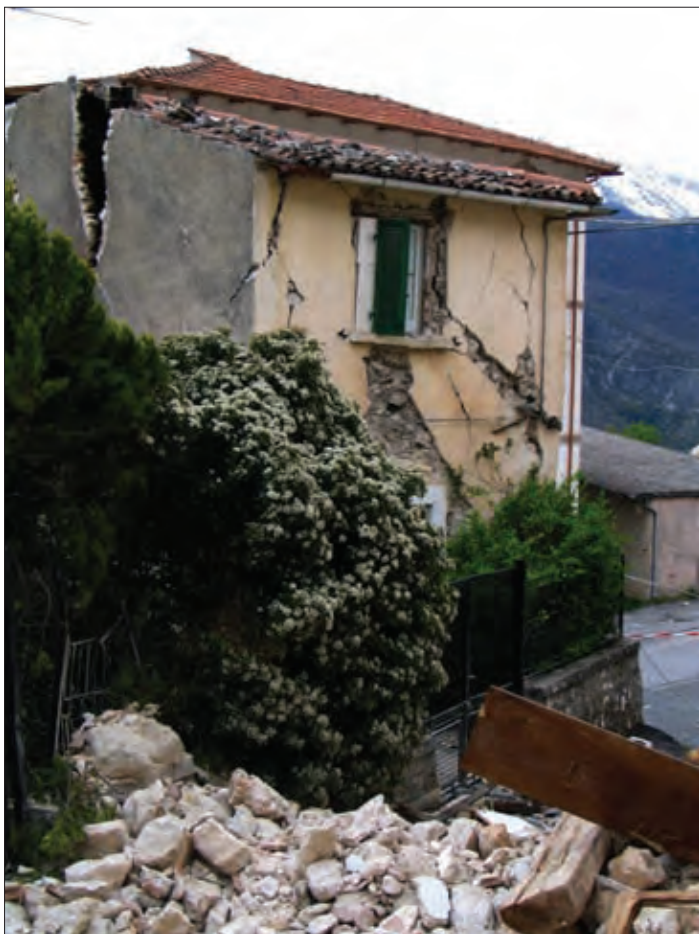
Slika 6. Vallecupa: hude poškodbe so nastale kot posledica ločevanja nepovezanega zidovja. (avtor posnetka: M. Godec)
