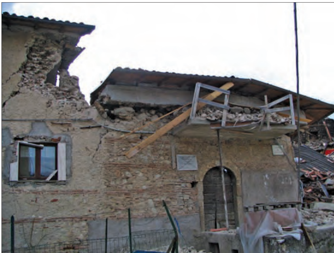
Slika 9. Tempera: porušitev zidane zgradbe, ki je bila ojačana z betonskih vencem. (avtor posnetka: M. Godec)
