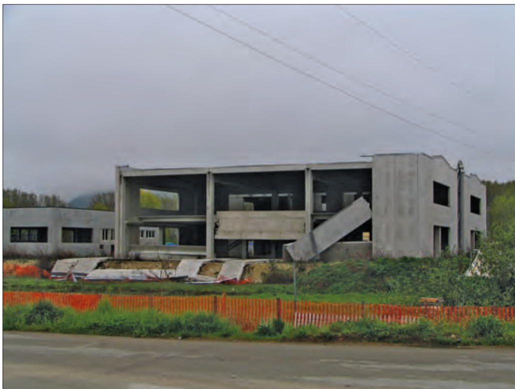
Slika 13. Monticchio: poškodbe na industrijski hali iz prefabriciranih elementov, s katere so odpadli deli fasade. (avtor posnetka M. Godec) Figure 13. Monticchio: precast facade element dropped from a prefabricated industrial building. (Photo by M. Godec)
