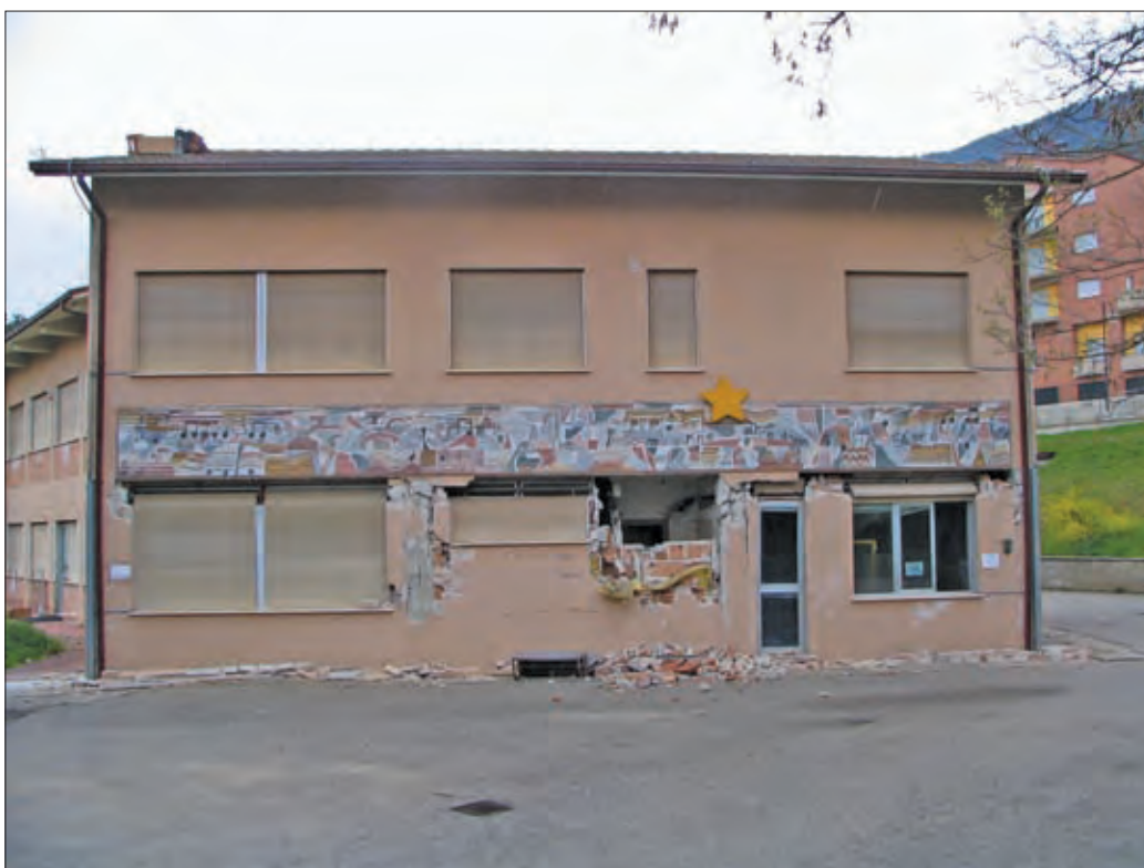
Slika 12. Pettino: obsežne poškodbe na osnovni šoli. (avtor posnetka: M. Godec) Figure 12. Petino: extensive damage to the elementary school. (Photo by M. Godec)
