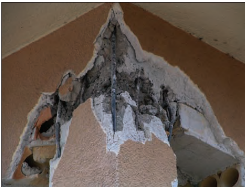
Slika 11. L'Aquila: ponekod je pri armiranobetonskih okvirih, grajenih pred več kot 30 leti, prišlo do porušitve stebrov ali prečk. Vzrok temu sta močno polnilo in slaba kvaliteta armiranega betona. Uporabljena je bila gladka armatura, stremenske armature pa sploh ni. (avtor posnetka M. Godec)
