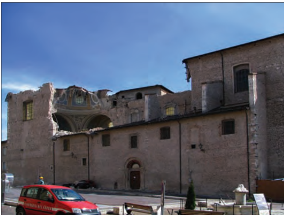
Slika 2. L'Aquila: v cerkvi Santa Maria di Paganica je prišlo do porušitve strehe in kupole. Cerkev je bila zgrajena že v XIV. stoletju, potres leta 1703 jo je porušil, zato je bila v XVIII. stoletju skoraj v celoti na novo zgrajena. (Avtor posnetka M. Godec)
