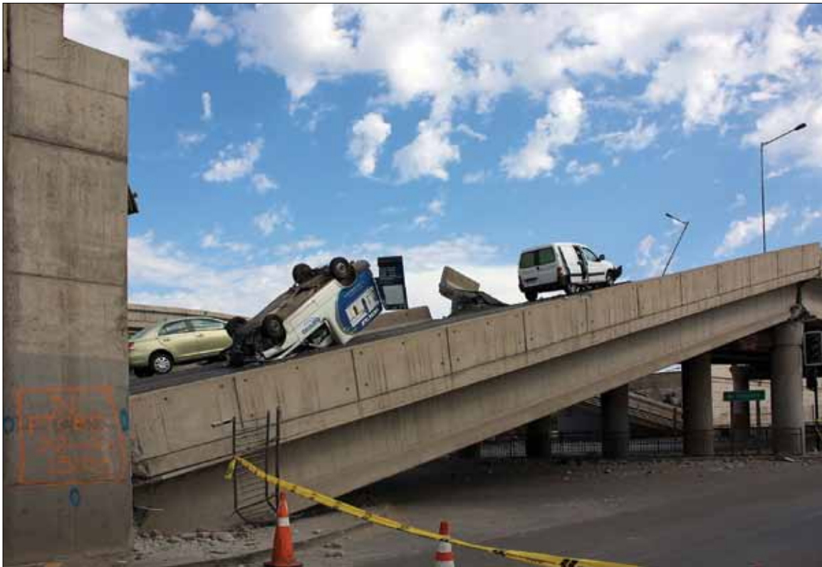
Slika 3: Autocesta Vespucio Norte v Čilu po potresu 27. februarja 2010 (vir: http://en.wikipedia.org/wiki/File:Vespucio_Norte_Highway_after_2010_earthquake.jpg )
