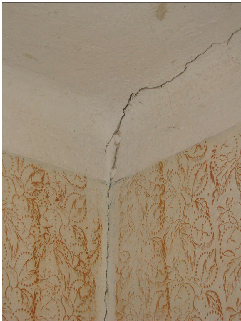
Slika 6: Poškodbe 2. stopnje na zgradbi v Hinjah, ki so nastale ob potresu 16. junija 2013 (foto: M. Godec)
