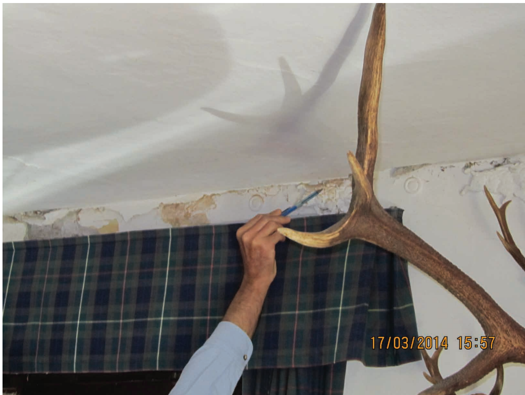
Slika 11: Razpoka in odpadanje ometa na stiku stropa in stene (foto: P. Zupančič)
