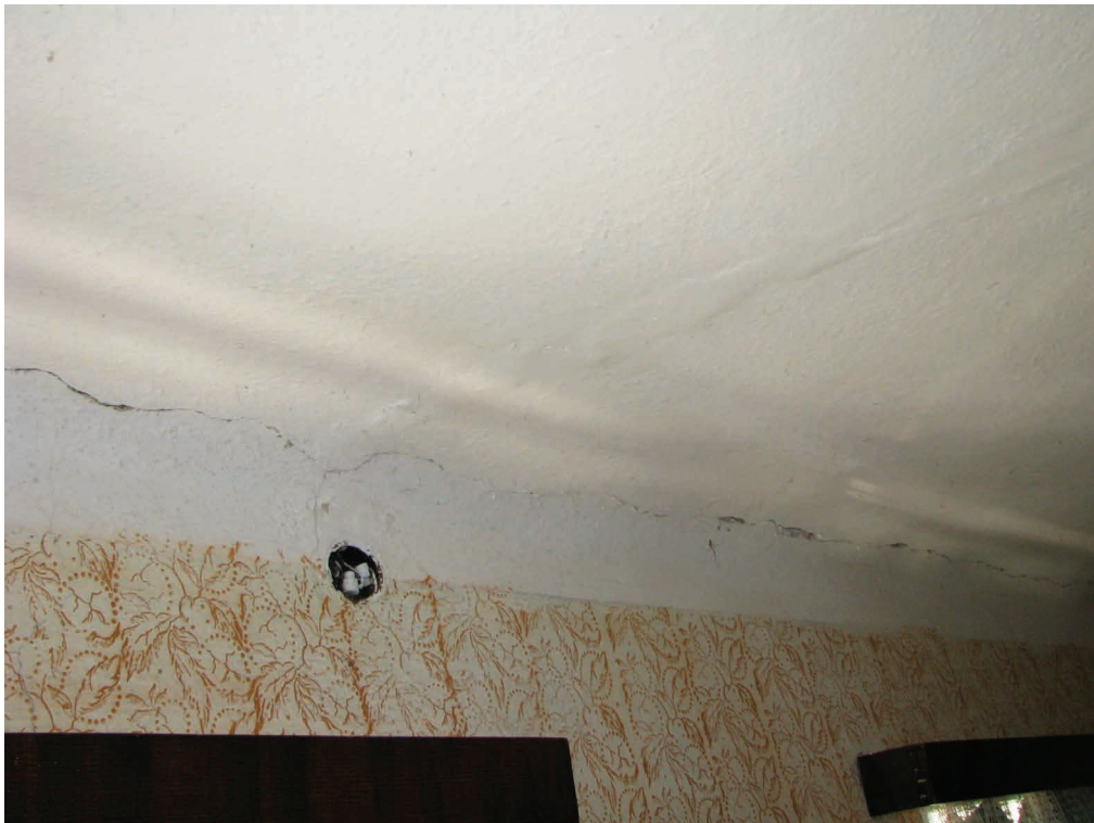
Slika 8: Globoke razpoke na stiku stene in stropa – posledica nepovezanega zidovja (foto: M. Godec)
