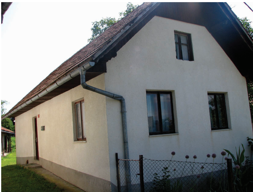
Slika 5: Stanovanjska hiša v Hinjah po potresu 16. junija 2013; poškodbe te hiše so prikazane na slikah 6–9 (foto: M. Godec)
