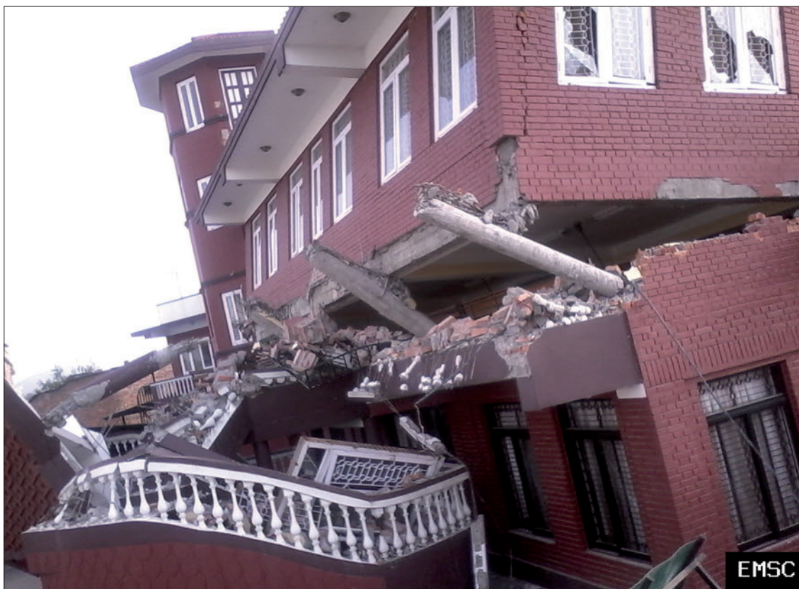
Slika 5: Poškodovana zgradba v mestu Madhyapur Thimi (88 km JV od žarišča) po potresu 25. aprila 2015 v Nepal
