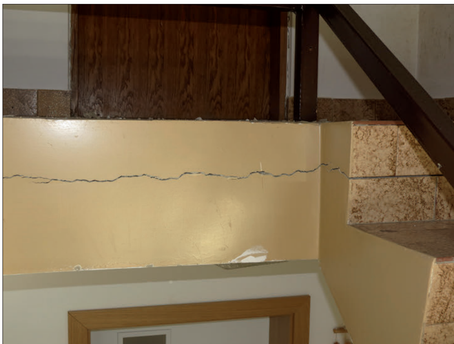
Slika 12: Razpoka na stiku armirano-betonske plošče in plavajočega poda na novejši hiši v Dobravi ob Krki (foto M. Godec)
