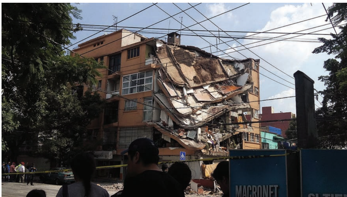
Slika 4: Poškodovana zgradba v Ciudad de México
